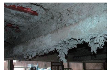
駐車場(青石綿の吹きつけ)
